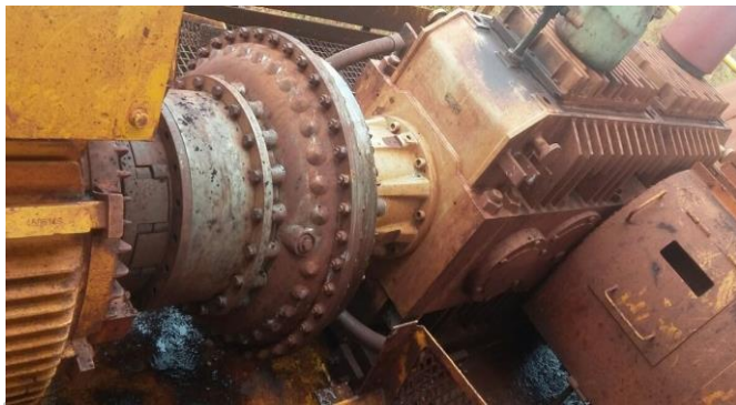
Antes – Acoplamento Hidráulico
